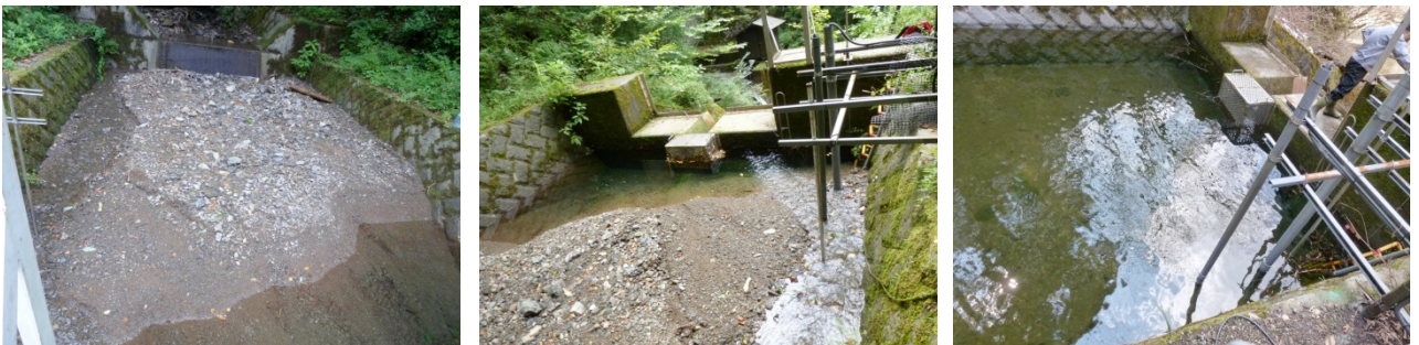
図2 量水堰の土砂堆積、浚渫の状況 (大洞沢 N03) 左・中 : H28. 9. 1 右 : H29. 4. 3
