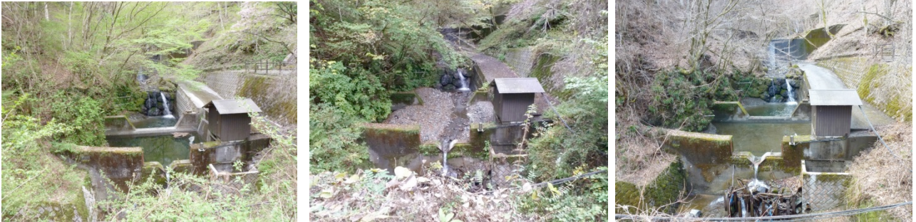
図1 量水堰の土砂堆積、浚渫の状況 (大洞沢 N01) 左 : H28. 4. 21 中 : H28. 11. 2 右 : H29. 4. 3
