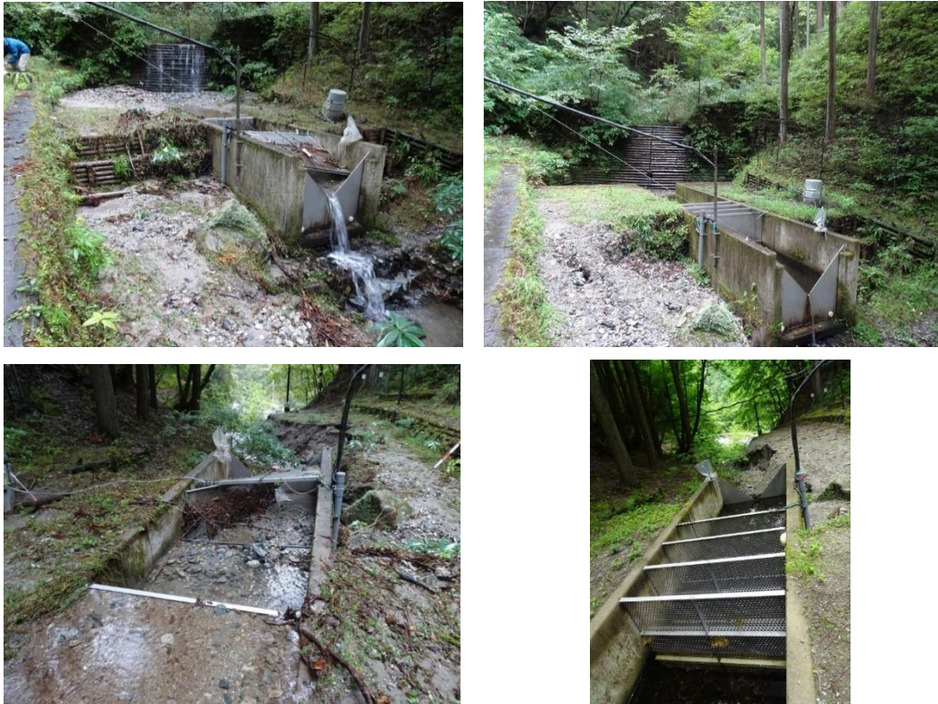
図-1 ヌタノ沢 A 沢量水堰の被災状況（左）と復旧状況（右）
